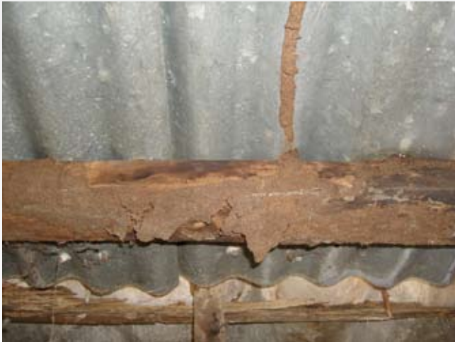
1 พบปลวกเข้าทำลายไม้แปรรูปของโครงหลังคาของอาคาร
